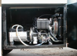
Электроагрегат АДА8-230РЛ установлен под кунгом на вахтовых вездеходах для обслуживания газопроводов
