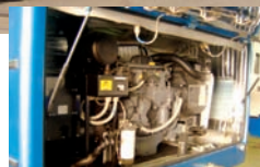
Установка электроагрегата АДС (двигатель DEUTZ + генератор SINCRO) P-120kW, напряжение 650 В постоянного тока на троллейбусе.
